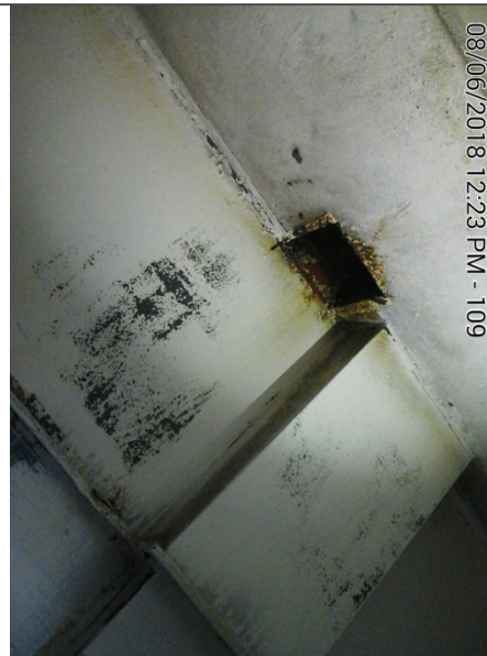
Fotografía No.4 Ducto de la estufa.
