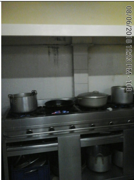
Fotografía No.3 Estufa de 4 puestos
